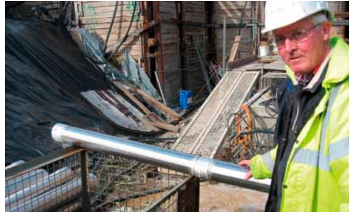
Als Filterrohre kamen Edelstahlwickeldrahtfilter von Stüwa zum Einsatz.
